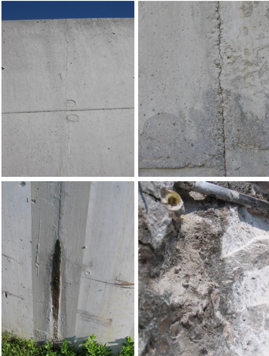
Slika 2: Poškodbe zunanje cilindrične stene čistilnega bazena in pronicaje agresivnih tekočin.
