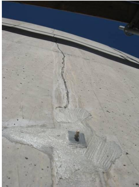
Slika 5: Tesnjenje razpok: (i) odpiranje razpok v obliki crke »V«, čiščenje, odpraševanje, (ii) vgradnja injekcijskih nastavkov, zapiranje razpok med injekcijskimi nastavki z epoksidno malto, (iii) sistematično injektiranje razpok s poliuretansko smolo ter odstranitev injekcijskih nastavkov
