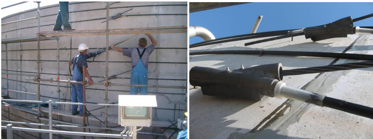
Slika 6: Nameščanje in napenjanje obročne kableske armature, pogled na nameščene sidrne glave, t.i. »X ancorage«.
